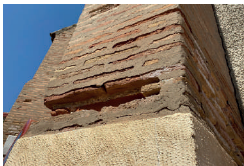
Detalle de grietas y humedades en uno de los contrafuertes.
