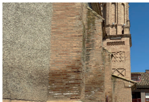
Detalle de humedades en la fachada principal.
