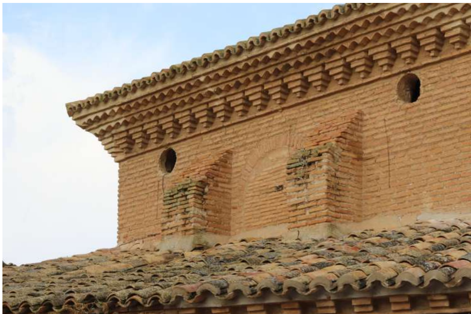
Vegetaciones en los contrafuertes de la iglesia de Bárboles.
