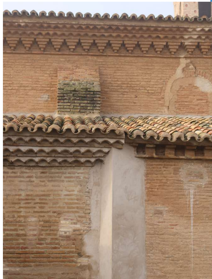
Vegetaciones y grietas de la iglesia de Bárboles.
