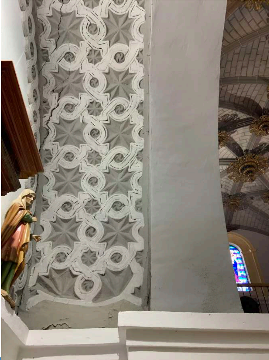
Grietas y fisuras en las pervivencias mudéjares.
