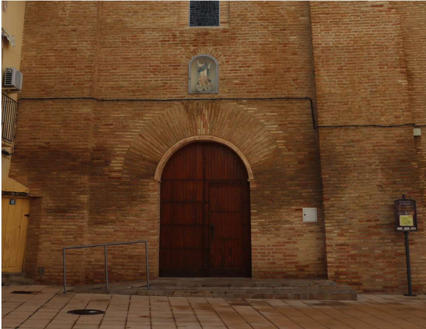
Humedades en la fachada de la iglesia de Bárboles.
