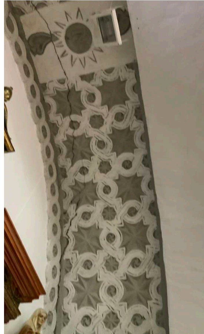
Grietas y fisuras en las pervivencias mudéjares.
