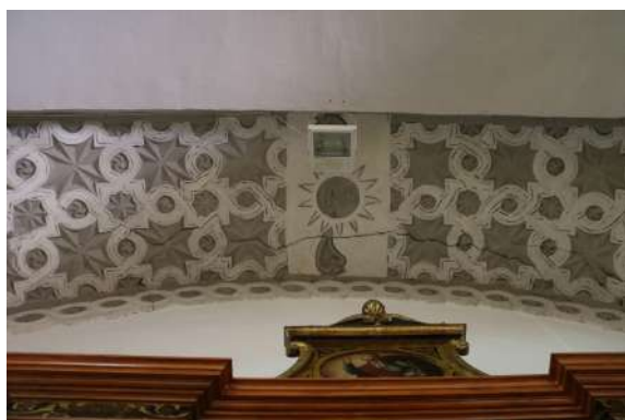
Detalle de grieta en las yeserías de Juan de la Marca
