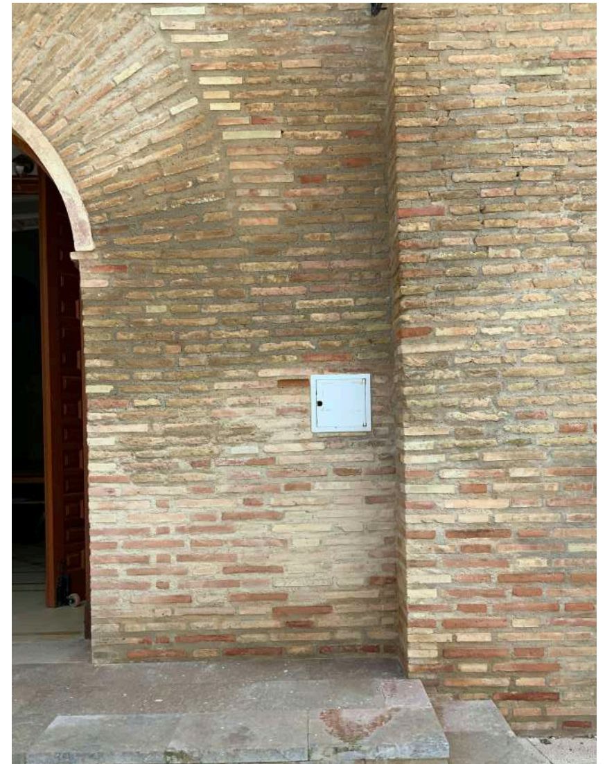
Humedades en la fachada de la iglesia de Bárboles.
