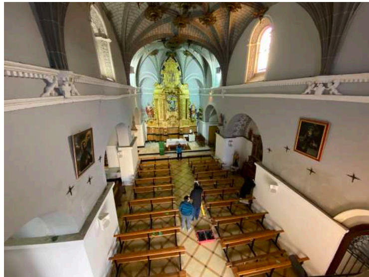
Humedades en la zona media de la nave central
