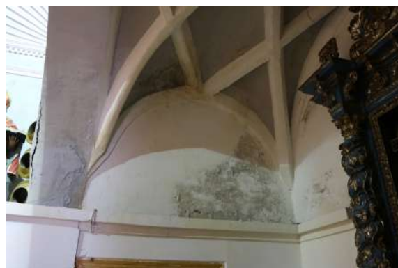
Humedades en la parte alta de la capilla de la Crucifixión
